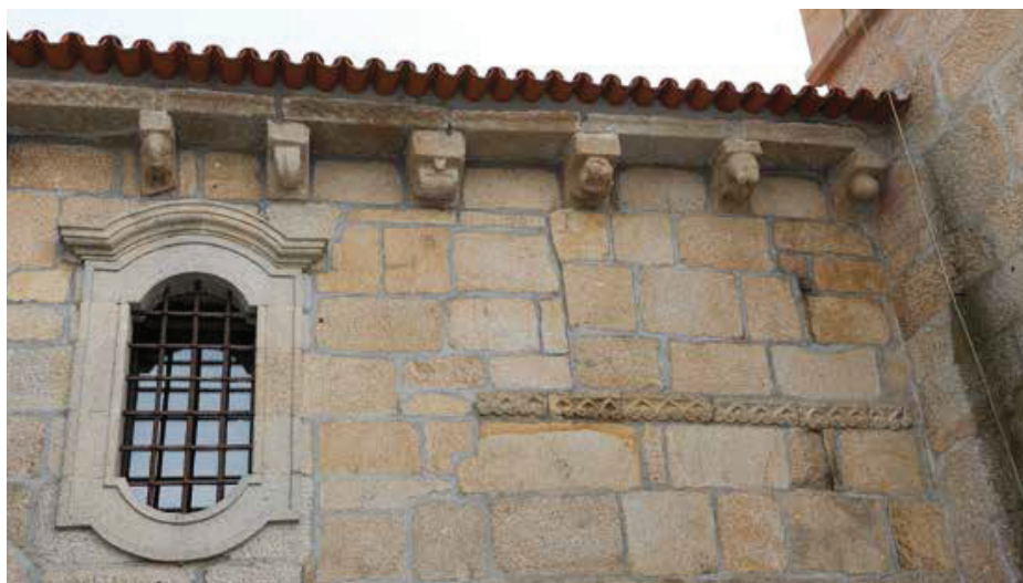
Fachada norte. Nave. Friso e intervenções posteriores.
