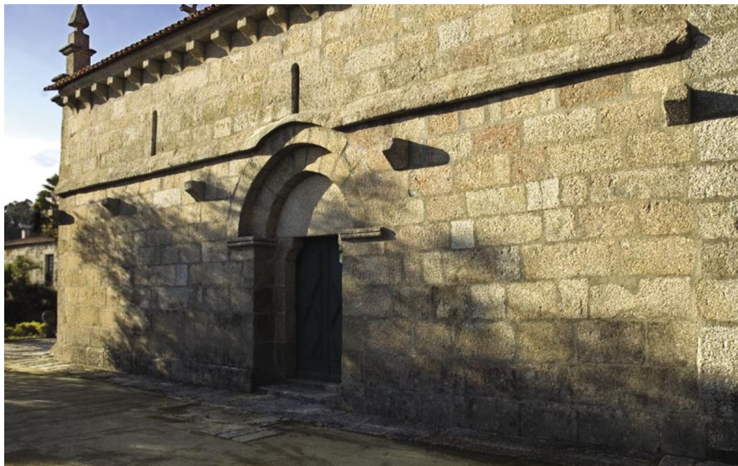
3. Fachada lateral sul. O lacrimal e as mísulas testemunham a existência de um alpendre.
